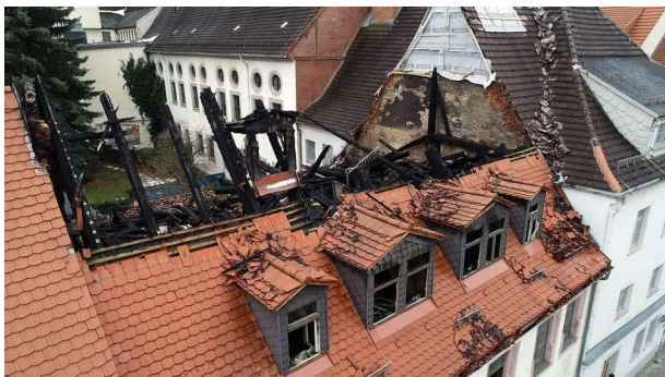
Ausgebrannter Dachstuhl in Freiberg/Sachsen, Foto: MDR, Sven Rathge
